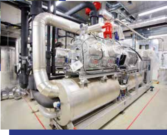
Grüne Wärme aus der Therme. In Oberlaa wird die Abwärme des Thermalabwassers zur Fernwärmeerzeugung genutzt. Rund 1.900 Haushalte werden so mit Wärme versorgt.
