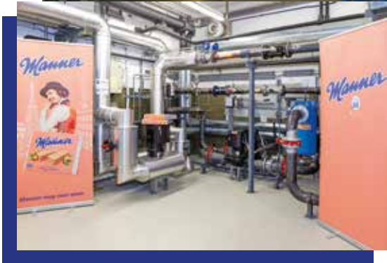
Manner „Schnitten-Heizung“. Die Abwärme in der Produktion wird für die Wärmeerzeugung verwertet.
